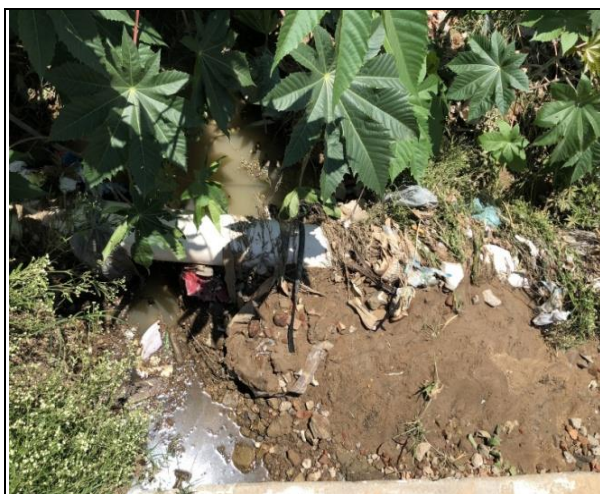
FOTO 05: Tubulação principal da rede coletora aparente, sem envelopamento.
