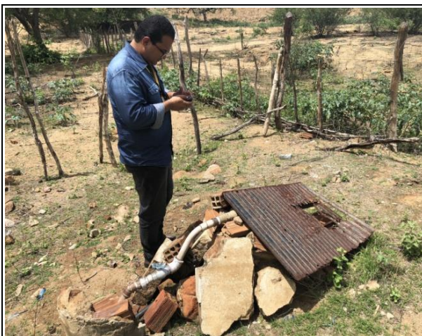
FOTO 01: Poço que alimenta o dessalinizador.
