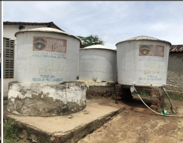
FOTO 04: Reservatórios de água bruta, chafariz e rejeito.
