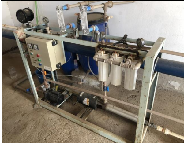
FOTO 03: Equipamentos de dessalinização.
