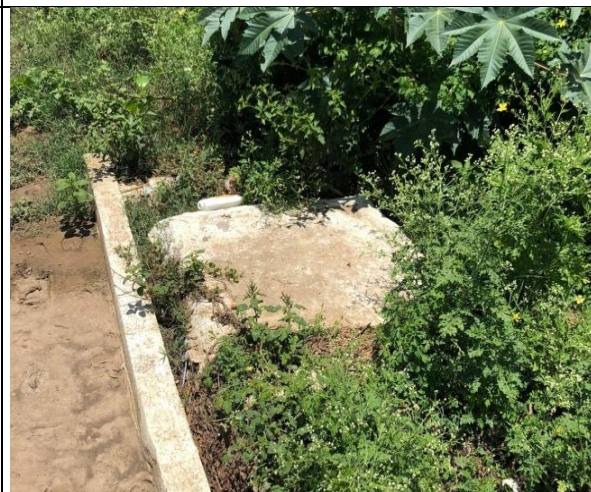
FOTO 08: Último Poço de Visita (PV) construído na rede antes do despejo final.
